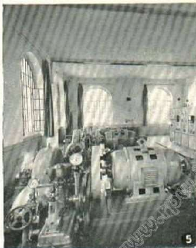
1. La Centrale dello Zerbo, in riva al lago. — 2. La condotta forzata dell'impianto dell'Alta Pioverna. — 3. Il bacino dell'impianto dello Zerbo (m. 970 s.m.). — 4. La centrale dell'Alta Pioverna. — 5. L'interno di una centrale con i gruppi turbina alternatore ed il quadro di manovra.
